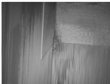
Rys. 4.14. Widok uszkodzonego ekranu kotła pod wlotem do cyklonu narożnego
