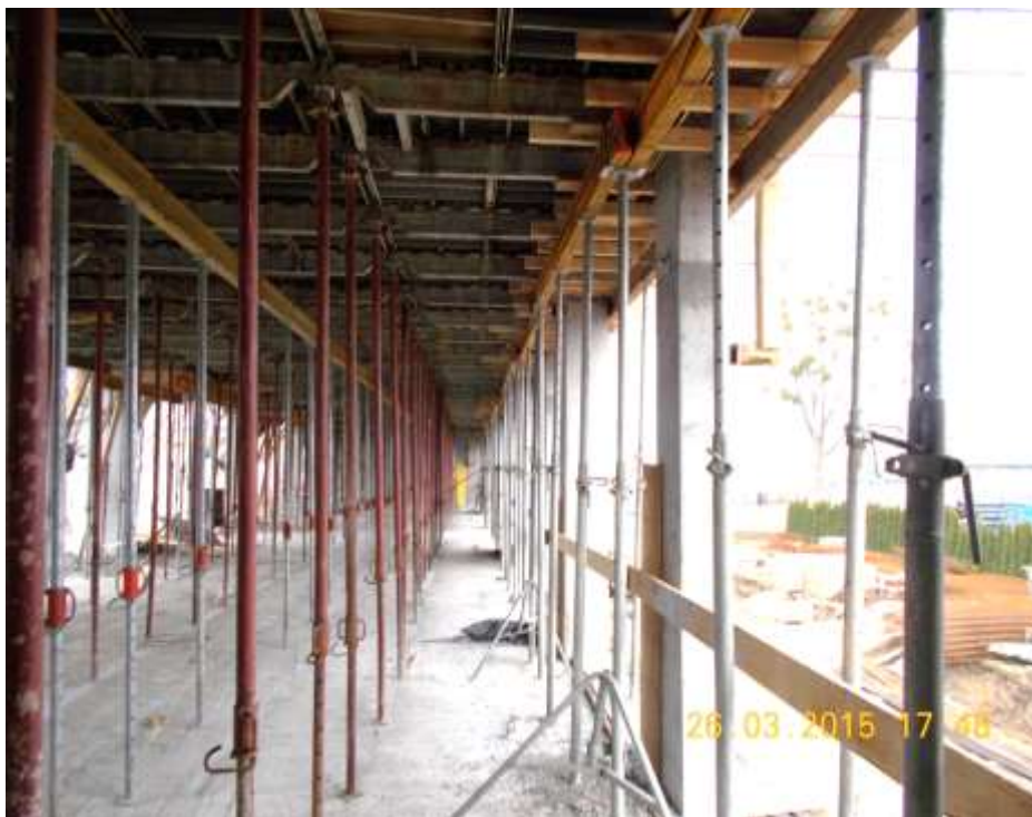
Fot. 1.7. Deskowanie stropu nad antresolą (nawa skrajna) – widok z dołu przy osi D
