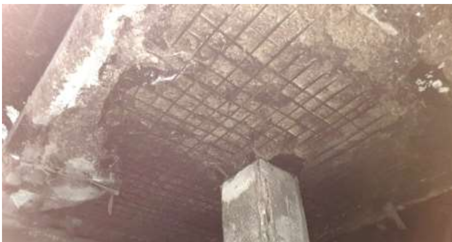
Fot. 2.2. Uszkodzenie słupa oraz pogrubienia stropu (grzybka) w rejonie pożaru
