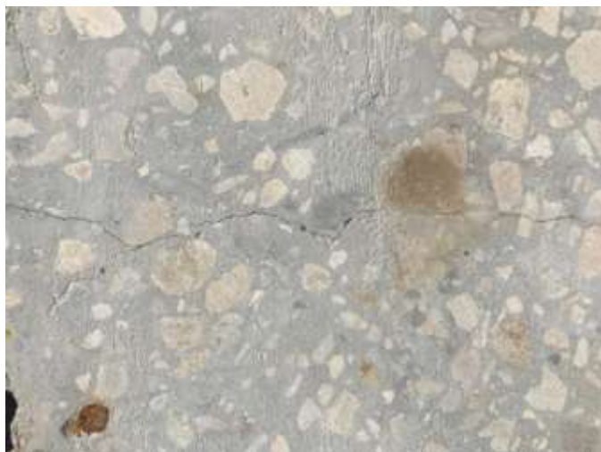
Fot. 4.5. Zarysowanie ścian fundamentowych budynku garażowego (widok 2)
