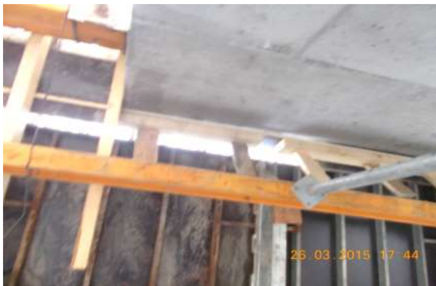
Fot. 1.13. Przemieszczone w stosunku do ściany żelbetowej deskowanie stropu (widoczny prześwit między ścianą a deskowaniem płyty)
