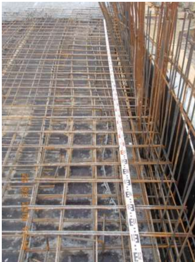
Fot. 1.4. Odkształcone zbrojenie wieńca w osiach C-D/7
