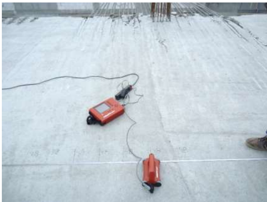
Fot. 1.8. Znaczniki prętów zbrojeniowych oraz mieszanej otuliny w badanym fragmencie płyty stropowej
