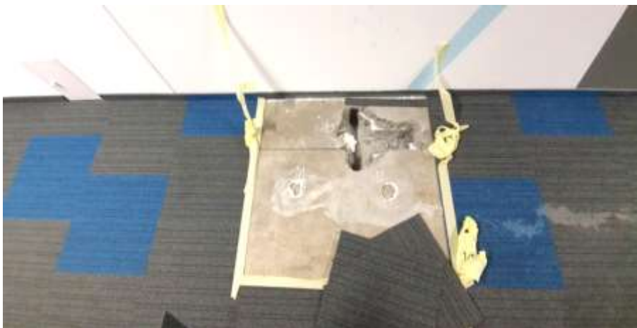
Fot. 2.3. Miejsce pobrania próbki zbrojenia górnego płyty stropowej
