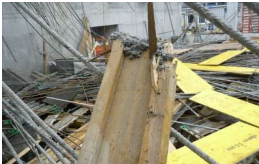
Fot. 1.15. Zniszczony dźwigar drewniany podpierający deskowanie płyty stropowej
