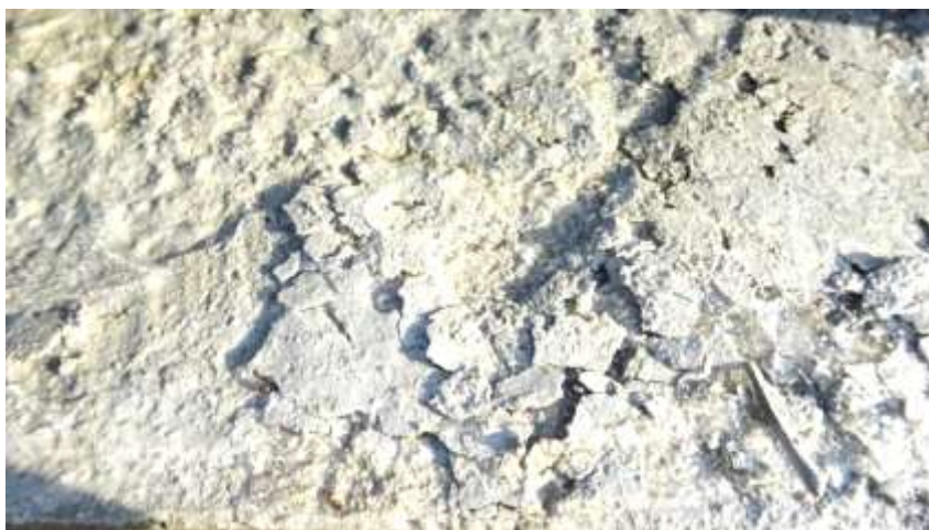
Fot. 4.6. Zniszczona płyta fundamentowa budynku garażowego
