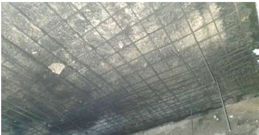
Fot. 2.1. Uszkodzenie płyty stropowej w rejonie pożaru
