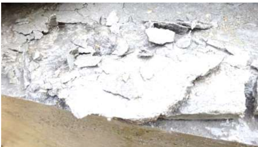
Fot. 4.2. Zniszczona płyta fundamentowa budynku mieszkalnego
