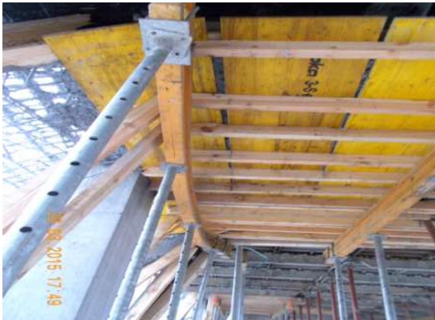
Fot. 1.11. Zdeformowany dźwigar podpierający deskowanie płyty stropowej w rejonie przecięcia się osi C/7
