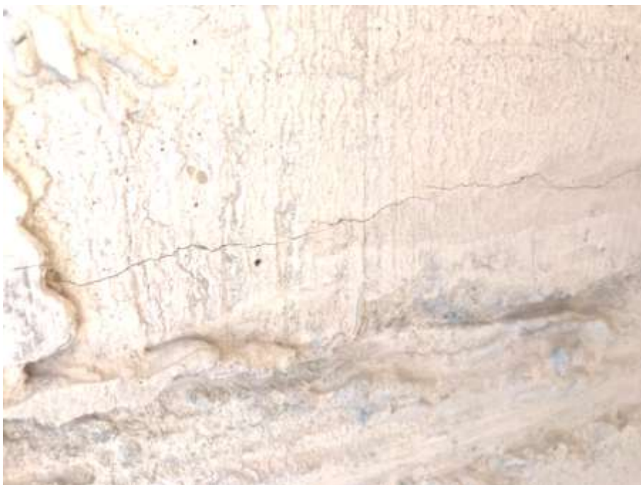
Fot. 4.1. Zarysowanie ścian fundamentowych budynku mieszkalnego
