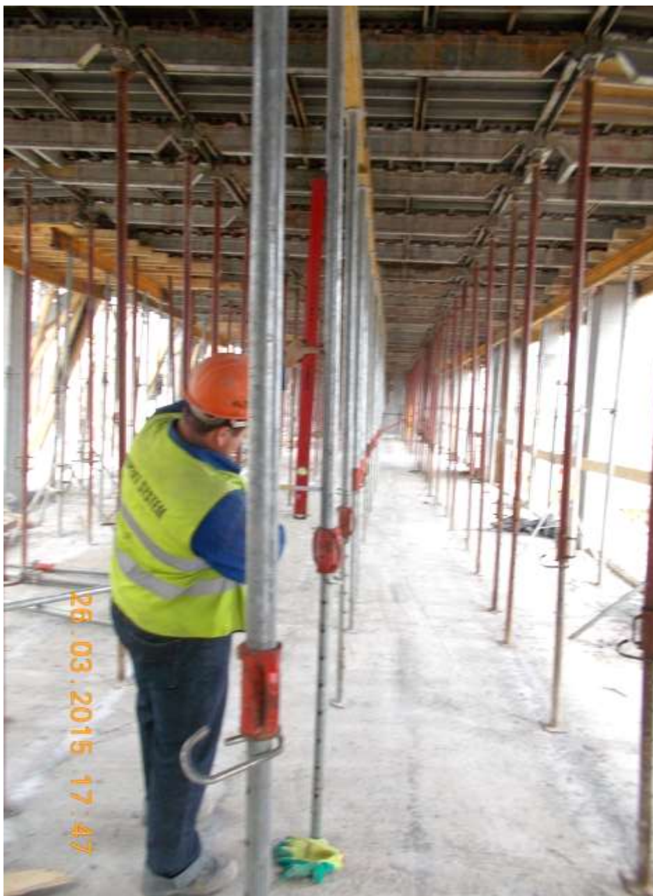
Fot. 1.14. Brak pionu podpory stropowej spowodowany przemieszczeniem poziomym deskowania
