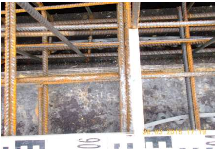
Fot. 1.5. Maksymalne przemieszczenie zbrojenia wieńca w osiach C-D/7
