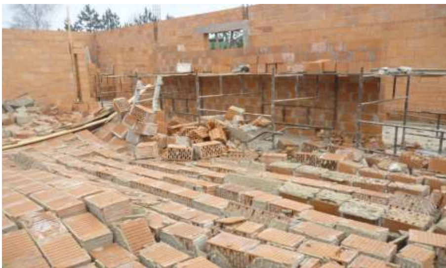
Fot. 3.2. Fragment zawalanej ściany – widoczne odspojenia poszczególnych pustaków
