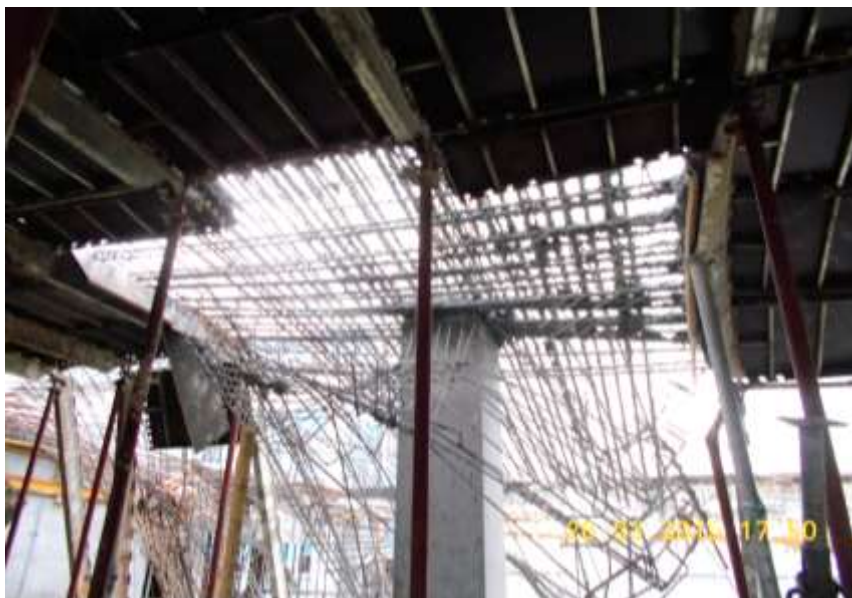
Fot. 1.12. Zniszczone deskowanie stropu przy grzybku słupa w osi C/7, widoczne zbrojenie grzybka
