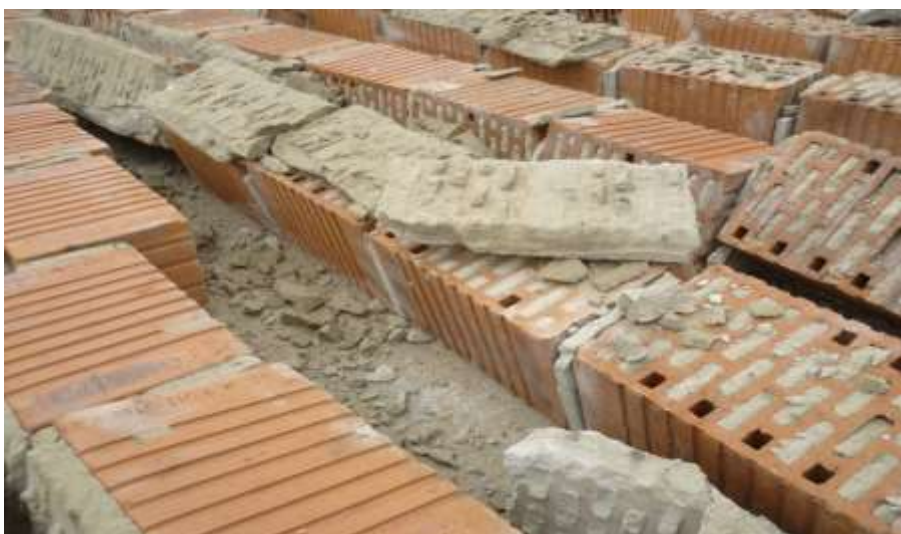
Fot. 3.4. Odspojona warstwa zaprawy murarskiej pobrana do badań laboratoryjnych
