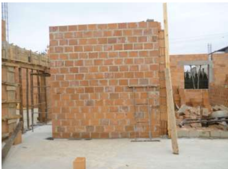
Fot. 3.3. Część ściany, która nie uległa katastrofie
