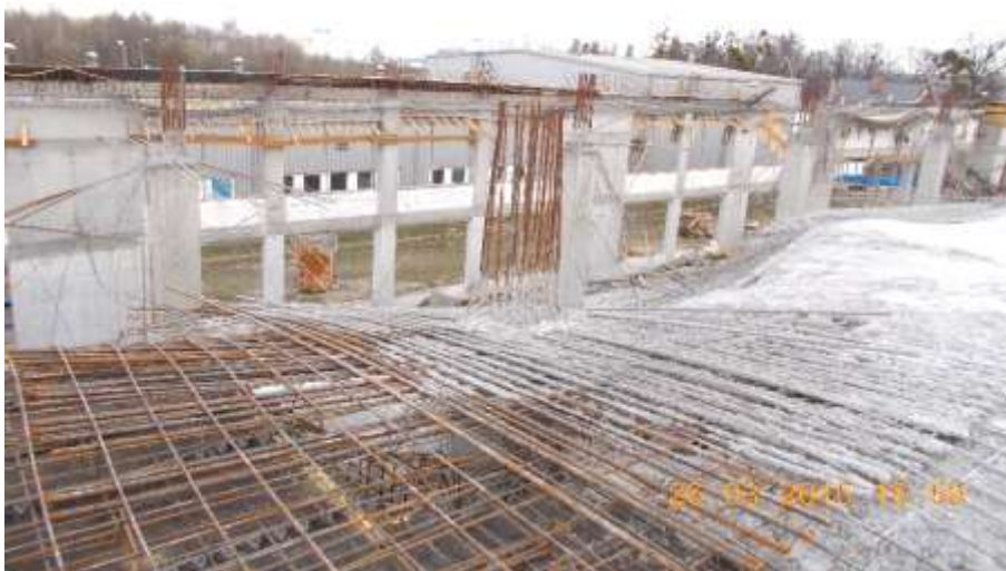
Fot. 1.2. Zdeformowane zbrojenie płyty w rejonie słupa C/7
