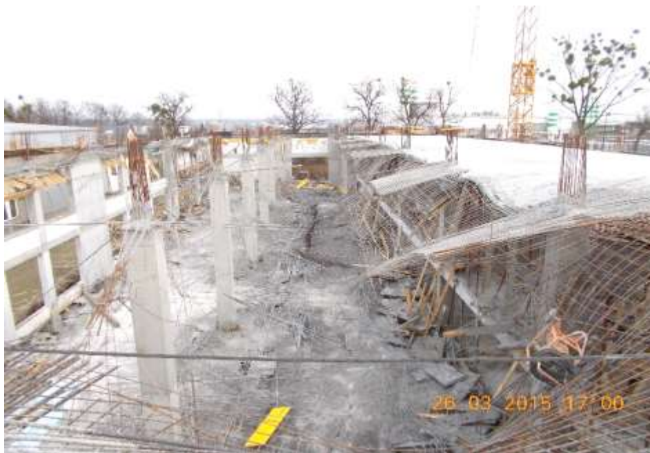
Fot. 1.1. Widok fragmentu stropu I kondygnacji, który uległ zniszczeniu podczas betonowania
