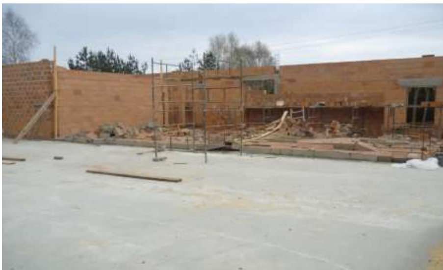
Fot. 3.1. Miejsce katastrofy budowlanej
