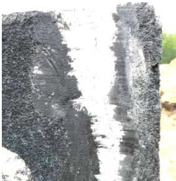
Fot. 4.4. Zarysowanie ścian fundamentowych budynku garażowego (widok 1)
