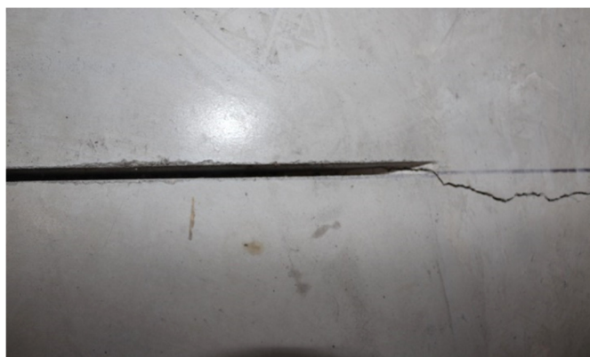
Rys. 1.16. Uszkodzenia krawędzi dylatacji
