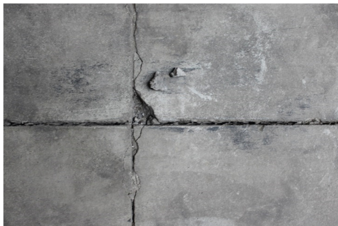
Rys. 1.15. Uszkodzenia krawędzi dylatacji
