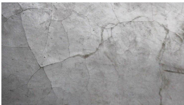
Rys. 1.18. Delaminacja warstwy utwardzonej posadzki
