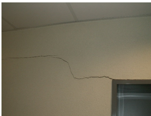
Rys. 4.1. Pęknięcie ściany w narożu otworu
