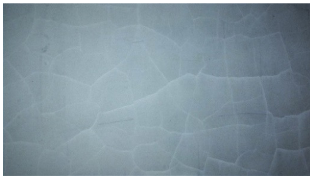
Rys. 4.3. Zarysowanie muru od odkształceń termicznych
