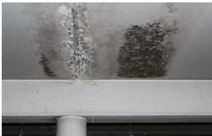
Rys. 1.13. Przecieki wody przez strop z płyt kanałowych
