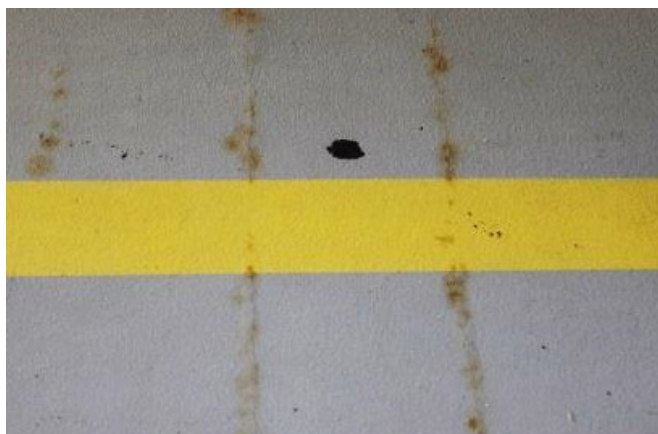
Rys. 1.22. Zabrudzenia posadzki wzdłuż skorodowanych prętów zbrojeniowych
