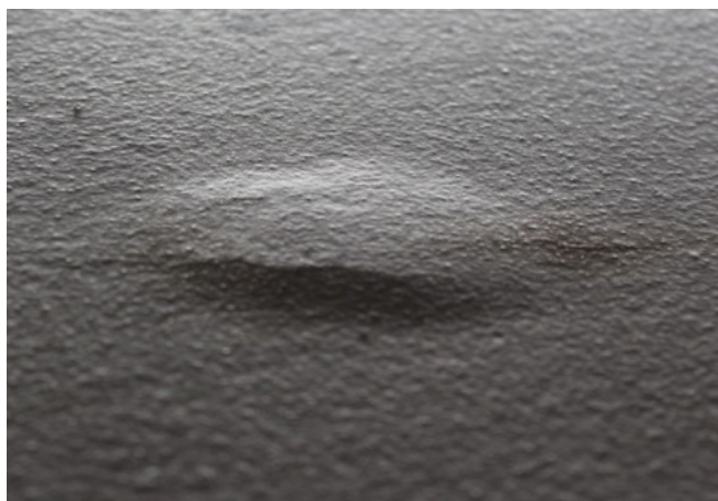
Rys. 1.21. Pęcherz w miejscu odspojenia powłoki żywicznej
