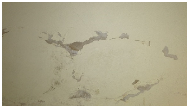
Rys. 4.5. Zarysowanie muru zawilgoconego
