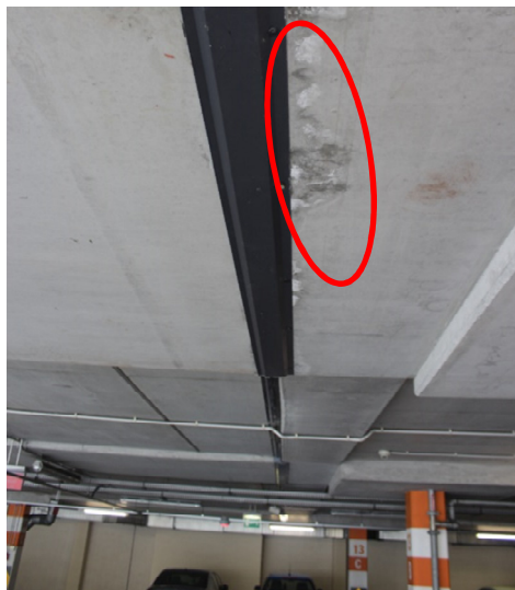
Rys. 1.14. Przecieki wody w obrębie obróbek dylatacyjnych
