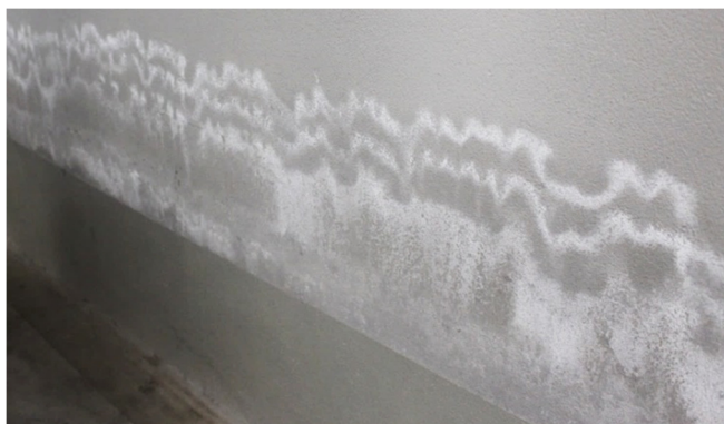
Rys. 1.10. Ślady zacieków na ścianach garażu podziemnego
