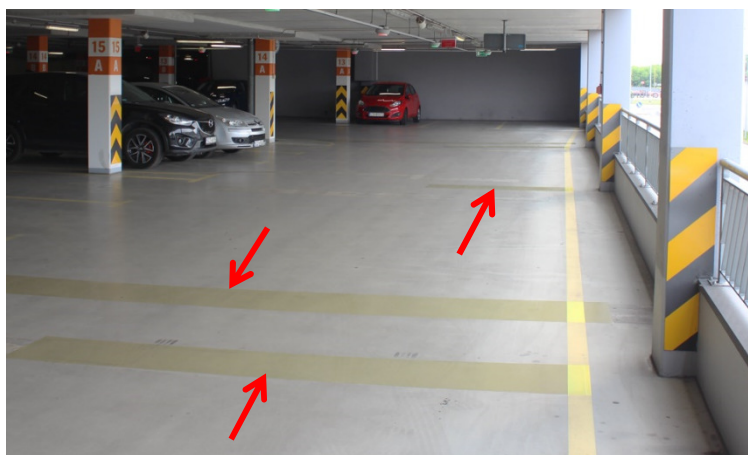
Rys. 1.11. Miejsca napraw pęknięć posadzki wzdłuż łączeń płyt stropu Filigran
