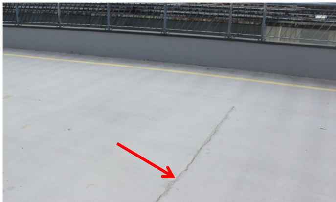
Rys. 1.12. Uszkodzenie posadzki na łączeniu płyt stropu Filigran
