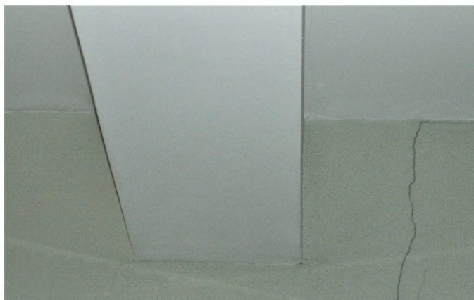
Rys. 4.7. Pęknięcie nienośnej ściany oddzielającej
