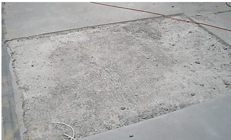
Rys. 1.23. Wycięty fragment uszkodzonej posadzki
