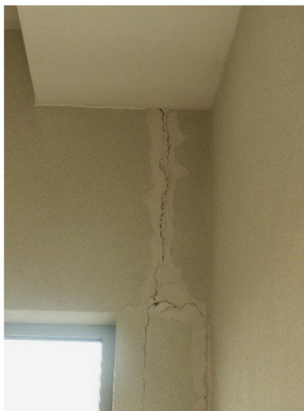
Rys. 4.8. Pęknięcia ściany po niepoprawnej naprawie
